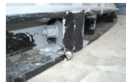
タンク底板フランジ接合部写真
